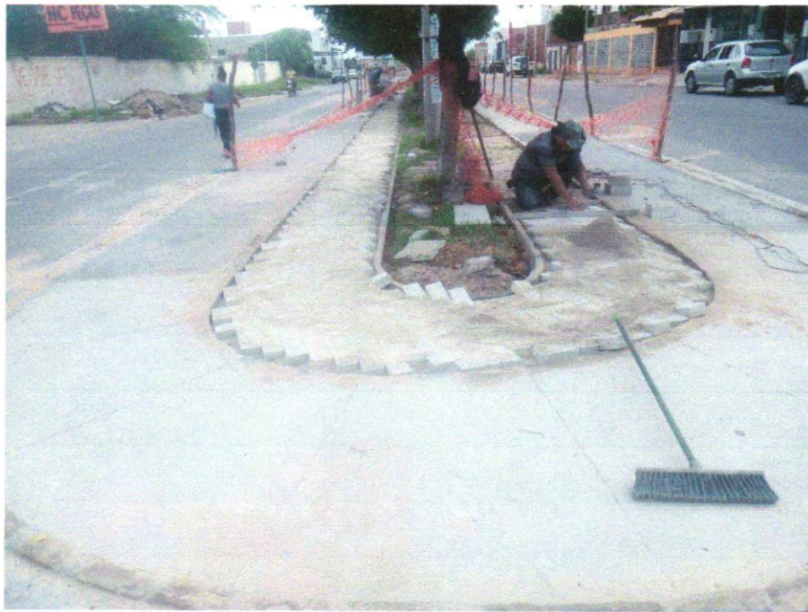
Foto 09- Pavimentação em bloco de concreto vibroprensado, intertravado, cor natural, 10x20cm, e=6cm, 46un/m 2 , NBR9781, Fck(min)=35MPa, sob coxim areia grossa compactada c/ placa vibratória, e(comp.)=6cm, rejuntado c/ areia fina.
