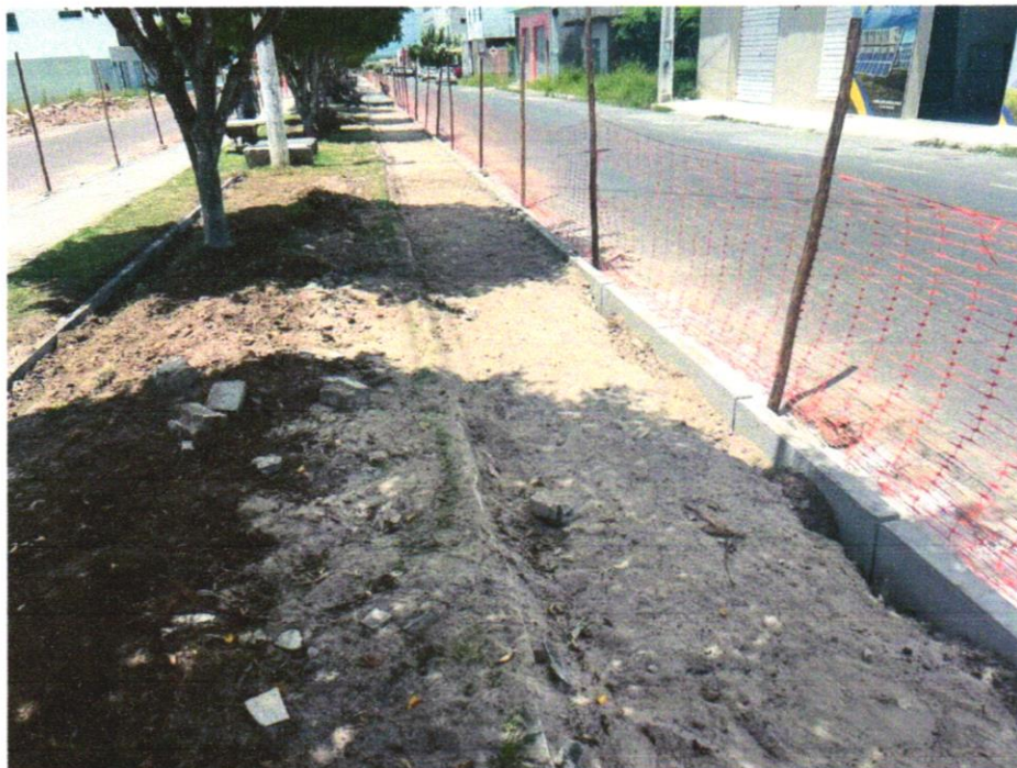
Foto 03- ASSENTAMENTO DE GUIA (MEIO-FIO) EM TRECHO RETO, CONFECCIONADA EM CONCRETO PRÉ-FABRICADO, DIMENSÕES 100X15X13X20 CM (COMPRIMENTO X BASE INFERIOR X BASE SUPERIOR X ALTURA), PARA URBANIZAÇÃO INTERNA DE EMPREENDIMENTOS. AF_06/2016_P
